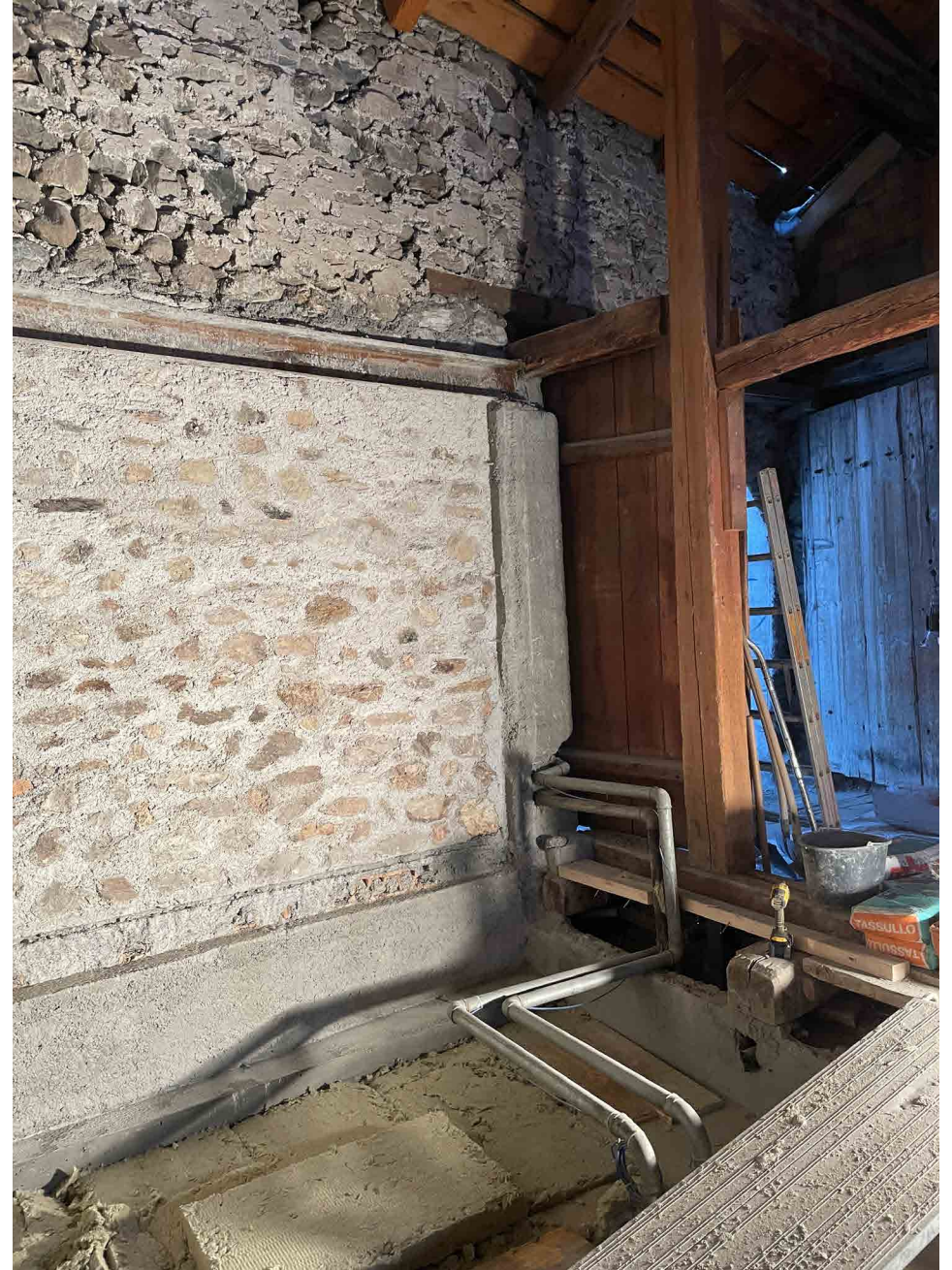
Die Decke über dem Oeltank ist abgebrochen 16.12.2022
